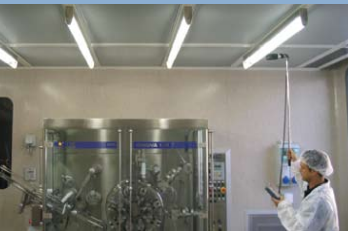
Uniformità del flusso laminare per tutti i filtri installati
